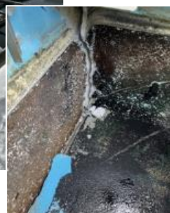
宝立浄水場浄水施設の損傷
