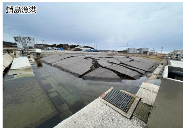
地震発生後の飯田港、蛸島漁港の様子
