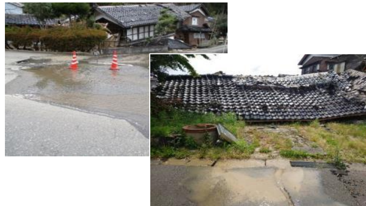
道路漏水(配水管の損傷)
