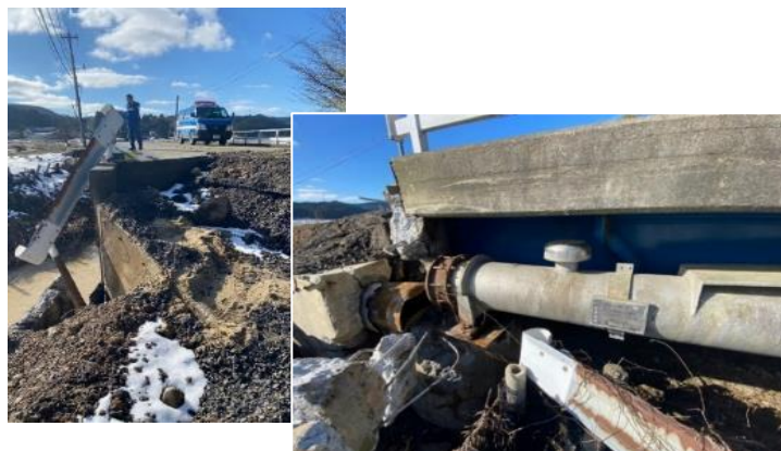
水管橋の損傷
