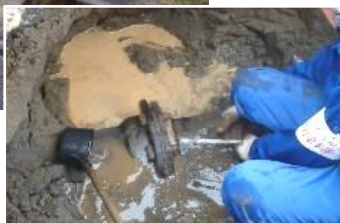
宝立浄水場導水管の損傷
