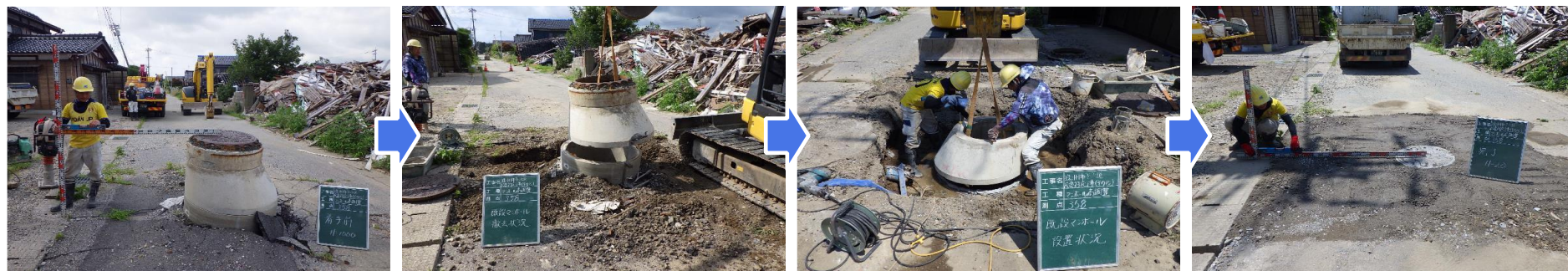
液状化により浮上したマンホールの復旧の様子
