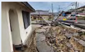
宅地の地割れ
