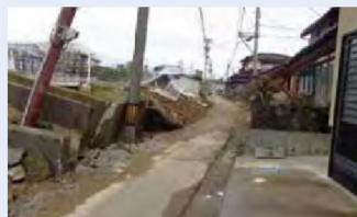
擁壁の転倒・崩壊
