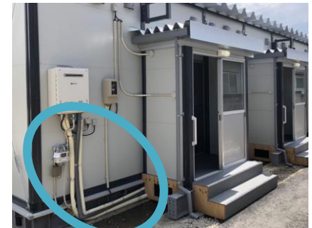
保温材が巻かれた仮設住宅の配管
