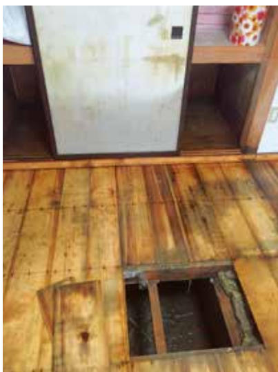
室内の被害状況も撮っておく
