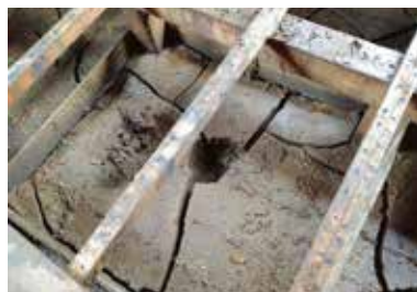
床下にたった泥（写真③）
