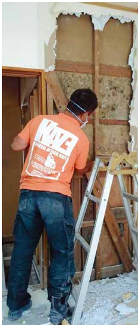
壁をはがすとカビが生えている
