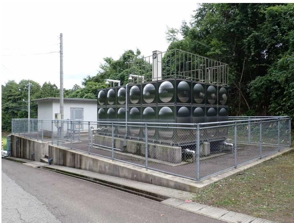
写 真：二子送水ポンプ場
