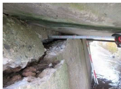
①左岸A1橋台：沈下(50mm) 移動(170mm)
