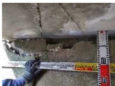
⑥左岸A1橋台：欠損[2000×200×200mm]
