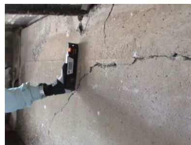
③右岸A2橋台：ひび割れ
