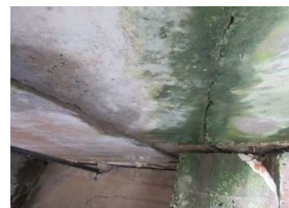
④主桁：ひび割れ
