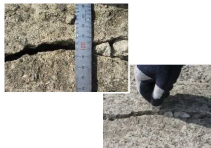
⑤橋面（コンクリート舗装）：ひびわれ [幅10mm、深さ100mm以上]
